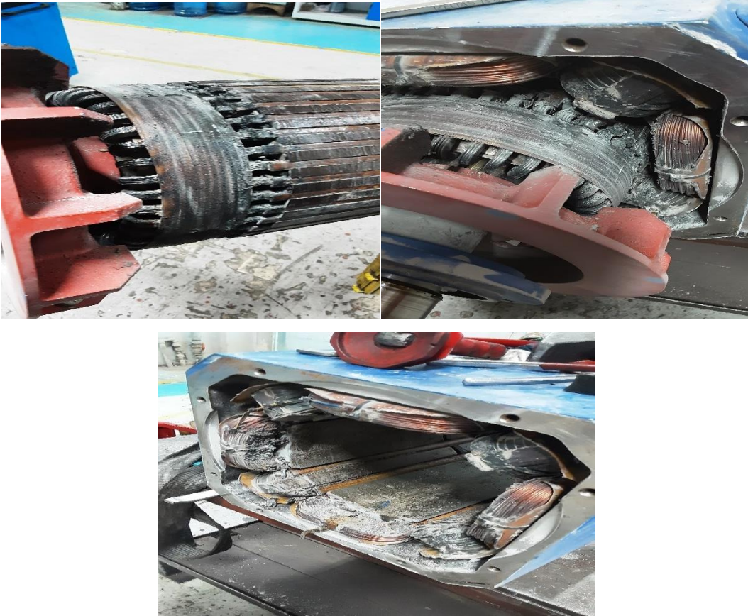
Şekil 2.16 Soğutma fanındaki filtre tıkanmasının sonuçları
