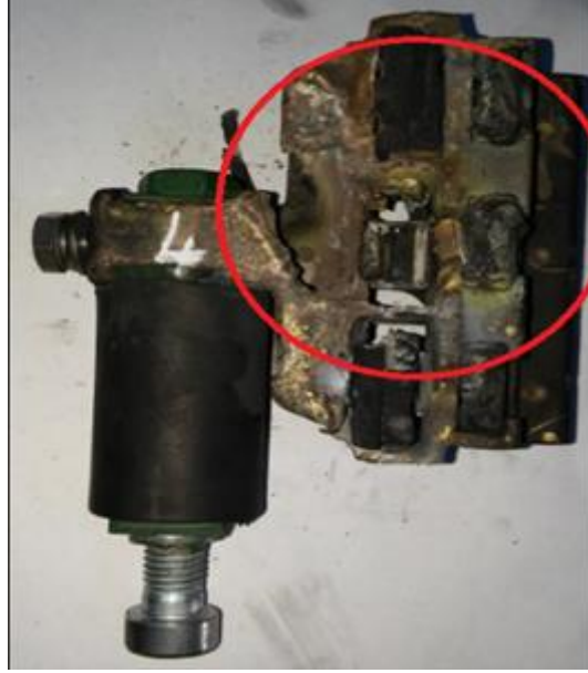
Şekil 2.15 Fırça ve fırça tutucu hasarı
