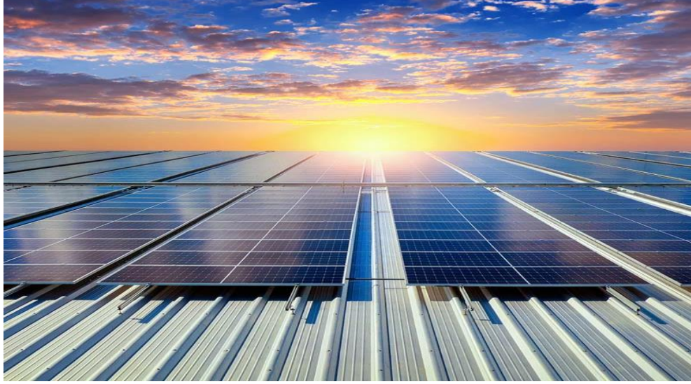
Şekil 4. 1 Çatıya Monte PV Panel Sistemi
